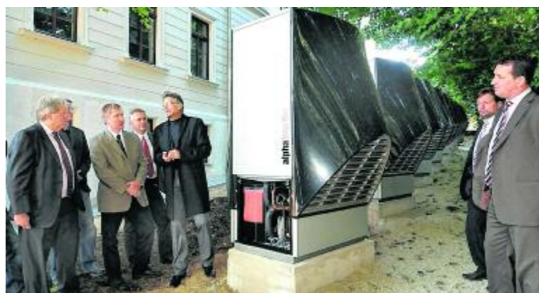
Innovativ, aber ebenfalls zu laut: die Luftwärmepumpen am Schulzentrum Hainichen, hier bei der Inbetriebnahme im September 2010. Der Energieverbrauch sank um 20 Prozent, doch nach Beschwerden der Anwohner musste die Stadt 55.000 Euro in Schallschutz investieren. FOTO: FALK BERNHARDT/ARCHIV
